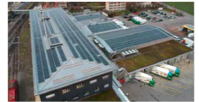
PV-Anlage Zollikofen (ca. 2800 m 2 )
