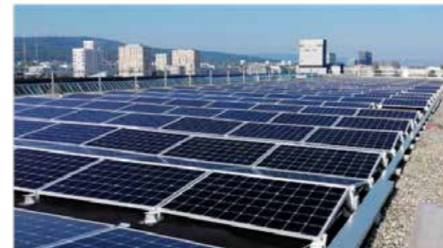
PV-Anlage Kellenberger (ca. 2500 m 2 )
